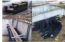
Imagen de la obra: instalación de colector en muro de hormigón insitu.
